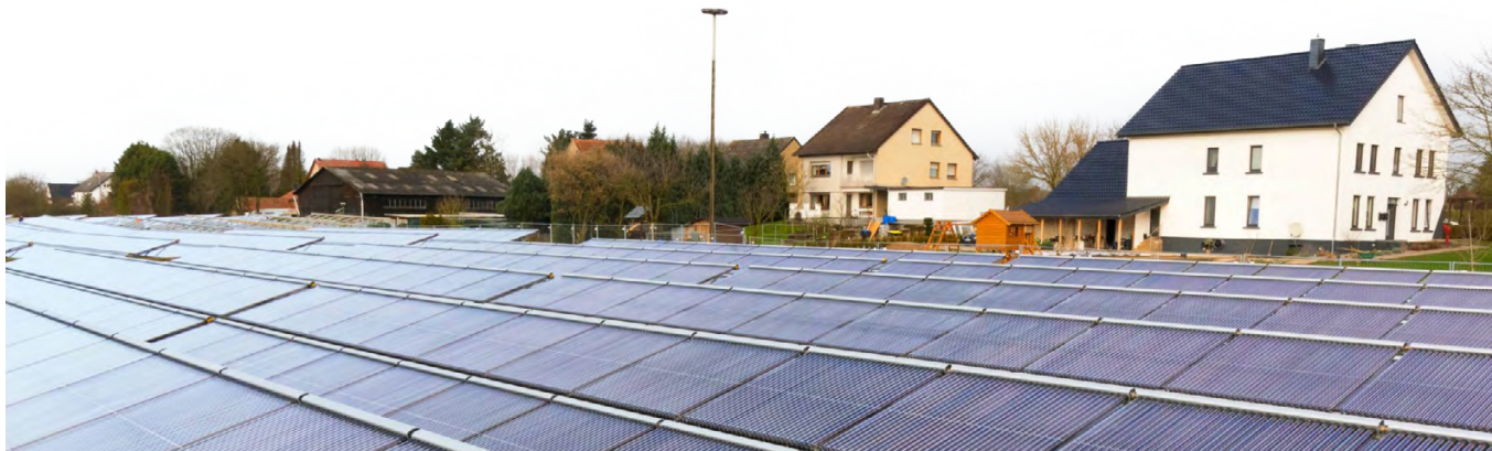
Das Kollektorfeld des iKWK-Systems der Stadtwerke Lemgo.
