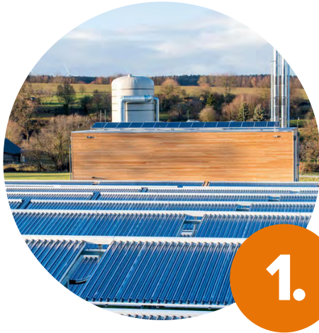
Solarthermieranlage und Heizzentrale in Ellern im Hunsrück
