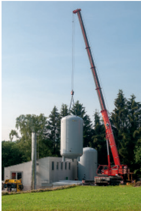
Je höher der Solaranteil, desto größer müssen die Speicher sein. In Randegg wurden zwei Tanks mit je 100 m 3 Volumen errichtet.
